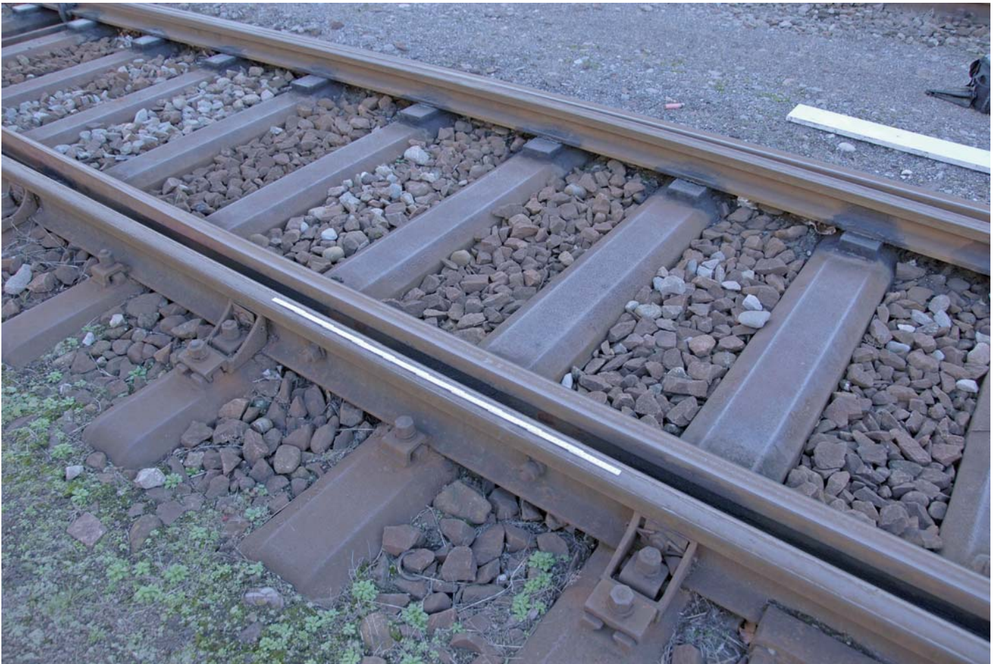
Gleitplatten und Schienenstützen
